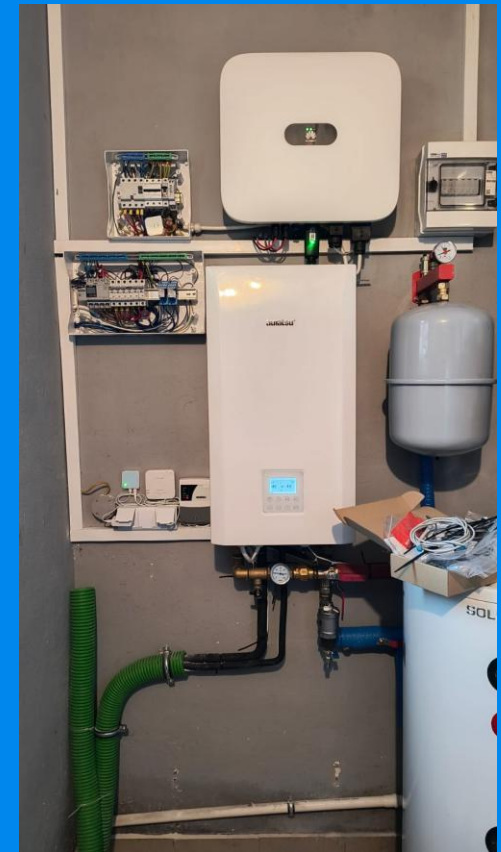
Auratsu Split Domowa instalacja
