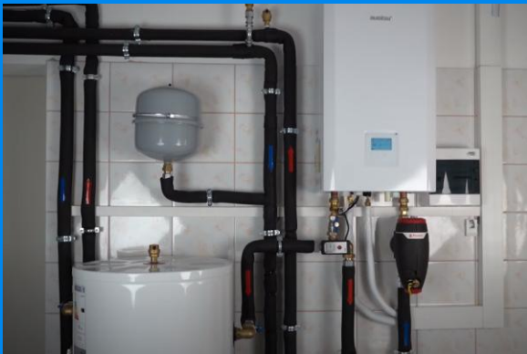
Auratsu Split Domowa instalacja
